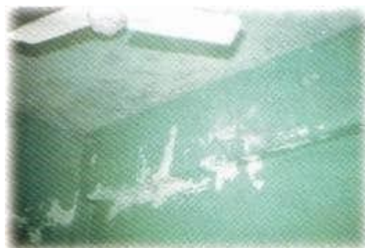
Рис.11: Утечка из кровельной плиты
