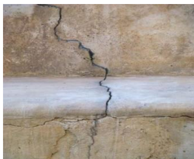
Рис.4: Бетонные строительные трещины из-за движения ползучести
