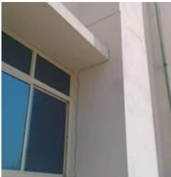
Рис.7: Трещина над окном из-за усадки
