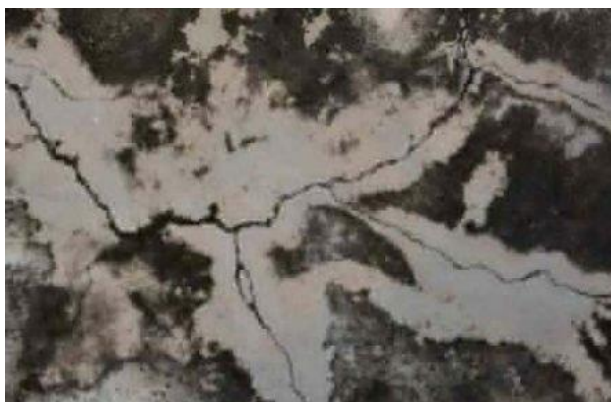
Рис.8: Бетонная трещина из-за движения влаги
