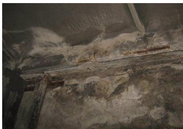
Рис.5: Растрескивание из-за коррозии арматуры
