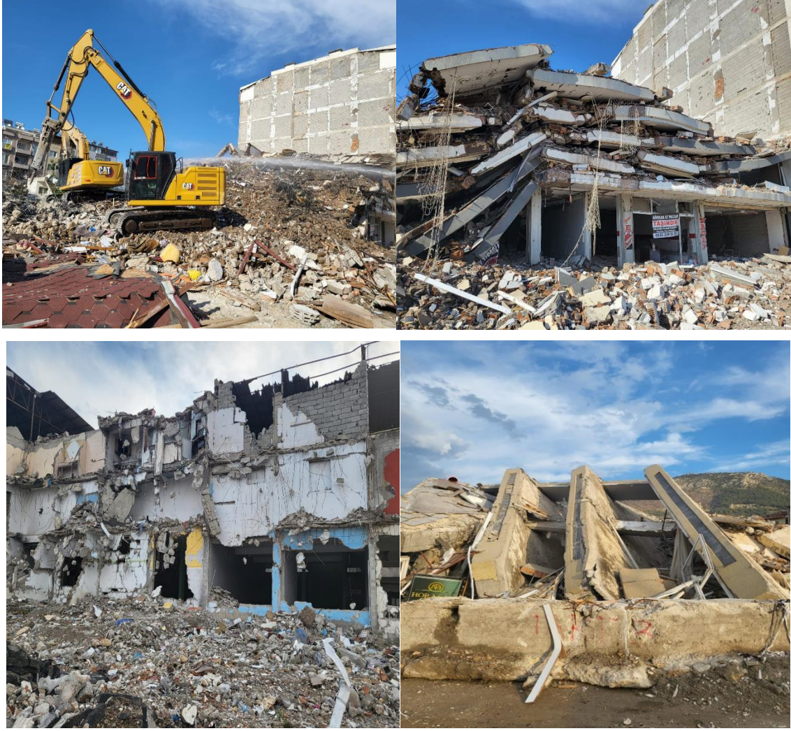
Şekil 1. 2023 Kahramanmaraş Depremi sonrası Hatay’da çekilen bazı fotoğraflar görülmektedir.
