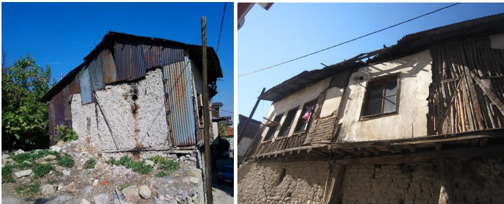
Görsel 46. Yapının güneydoğu cephesinde yer alan sağır duvar üzerindeki sac kaplama ve çatıda oluşan hasarlar, 2022
