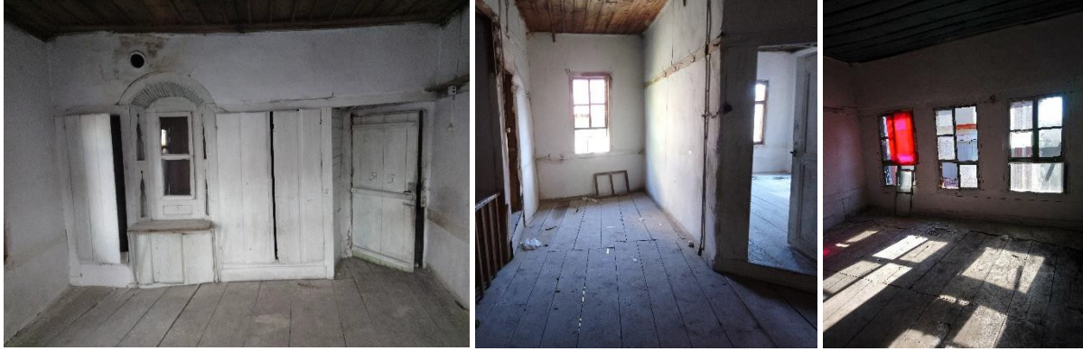
Görsel 45. Yapı içerisindeki dolap ve döşemelerde meydana gelen hasarlar ve bozulmalar, 2022
